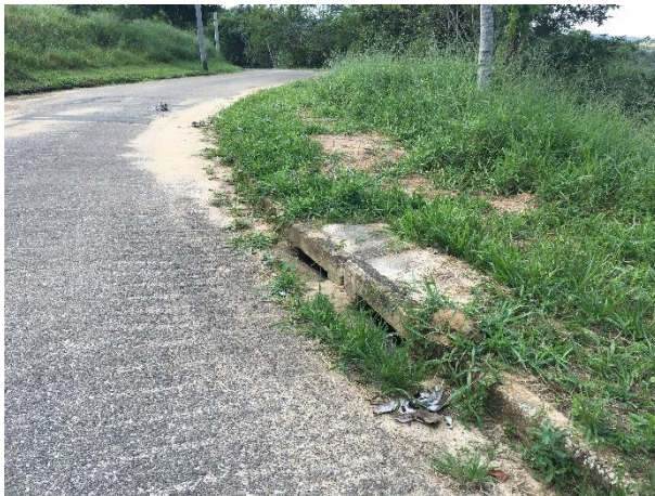
FIGURA 123 – BOCA DE LOBO FONTE: ACERVO DO AUTOR, 2022
