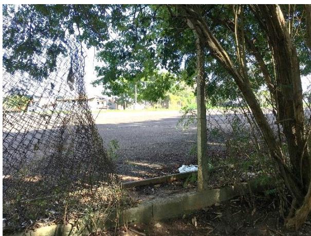
FIGURA 161 – GRADIL DANIFICADO FONTE: ACERVO DO AUTOR, 2022
