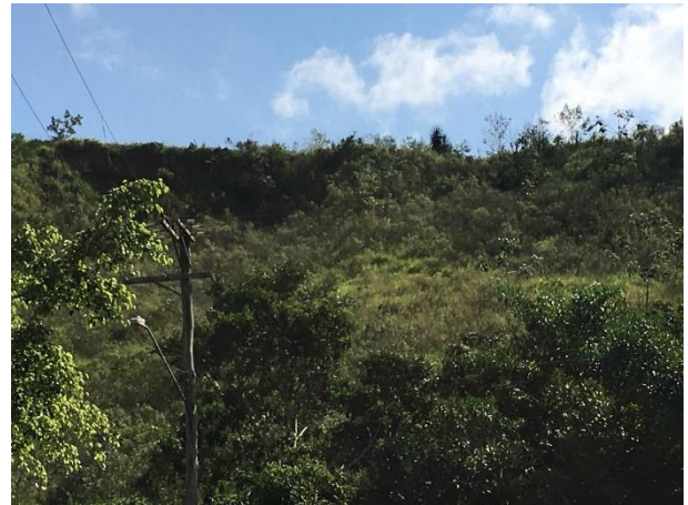
FIGURA 36 – EROSÃO – VISTA 02 FONTE: ACERVO DO AUTOR, 2022
